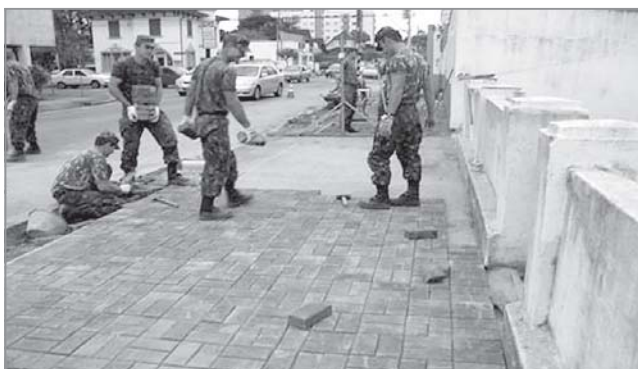
Figura 4. Execução de pavimentação com as peças de concreto com ADF no entorno do 62º Batalhão de Infantaria de Joinville.
